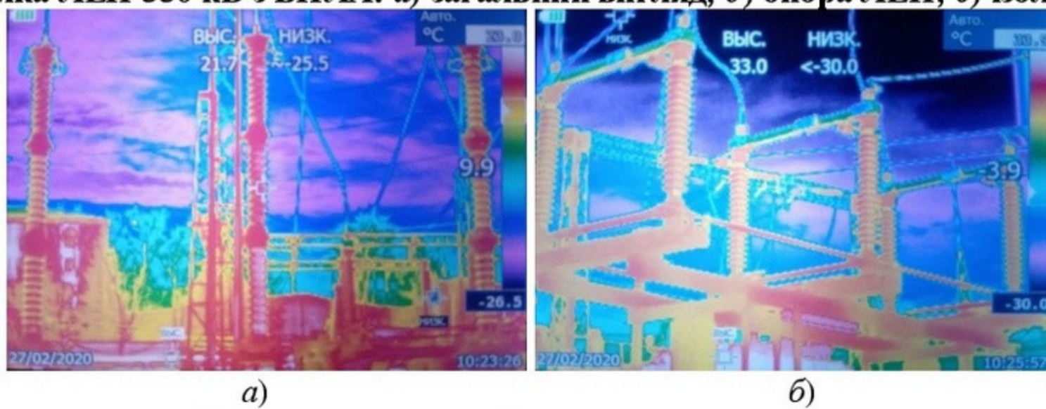
Рис. 2. Зйомка електрообладнання підстанції 110 кВ в інфрачервоному спектрі: а) вимикачі високовольтні 110 кВ; б) роз'єднувач
