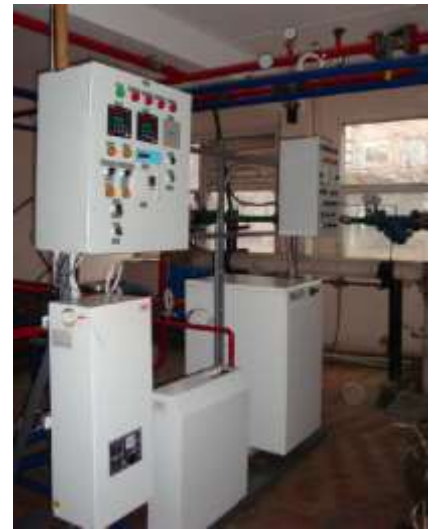
Рис. 6. Фрагмент ІТП з електричними котлами
