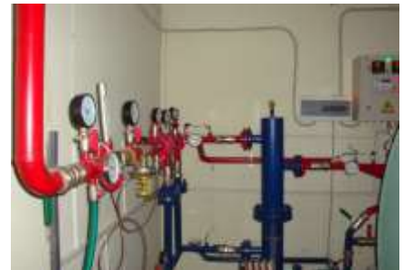
Рис. 7. Фрагмент ІТП з гідравлічною стрілкою
